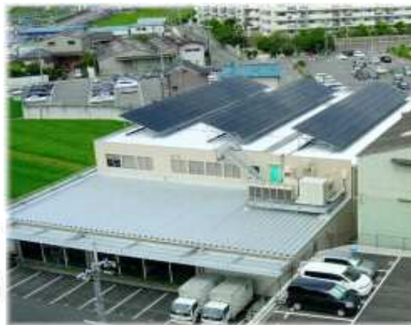
おおさかパルコープ寝屋川支所 30kW太陽光発電システム
