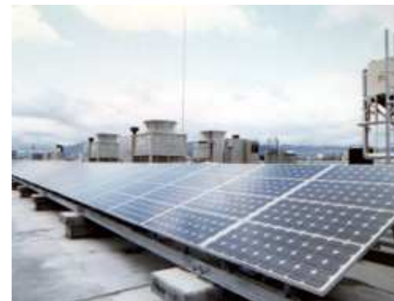
(写真)京都市立新町小学校殿 10kW 標準形太陽電池 陸屋根架台設置
