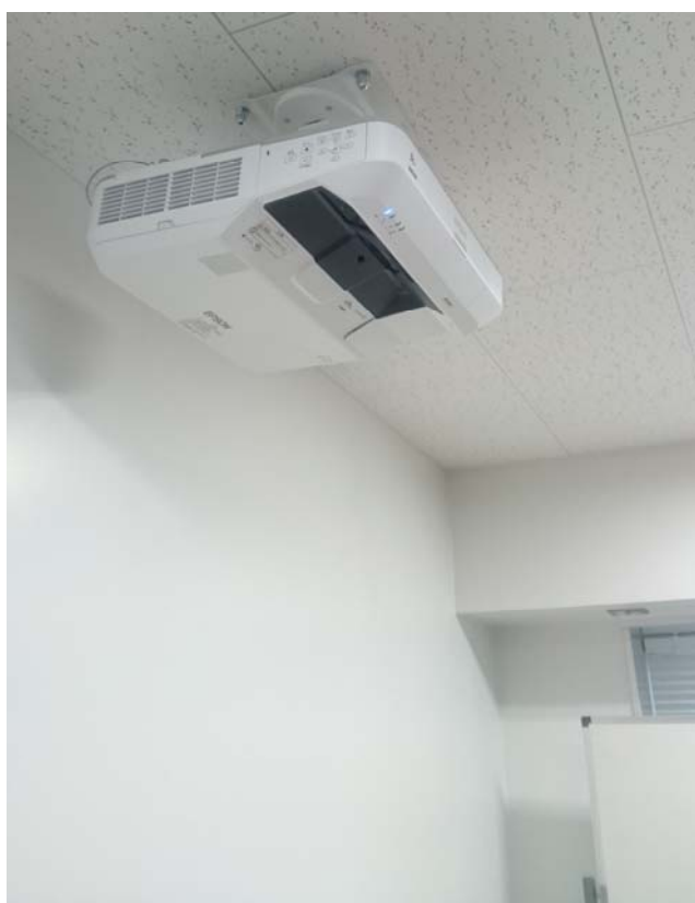
輪講室 2 部屋 (天吊プロジェクタ、椅子)
